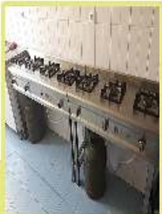
تجهیز آشپزخانه های کلیه خوابگاهها به اجاق گاز صنعتی استاندارد
