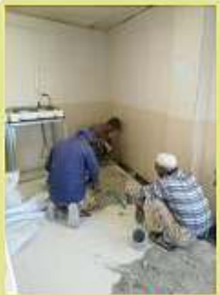
لوله کشی فاضلاب ماشین لباسشویی های خوابگاه ترگس
